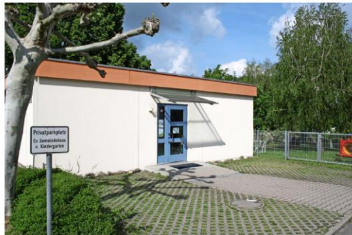
Der Pavillon, in dem der Kindergarten untergebracht ist, ist bald nicht nur zu klein, sondern auch stark sanierungsbedürftig.
